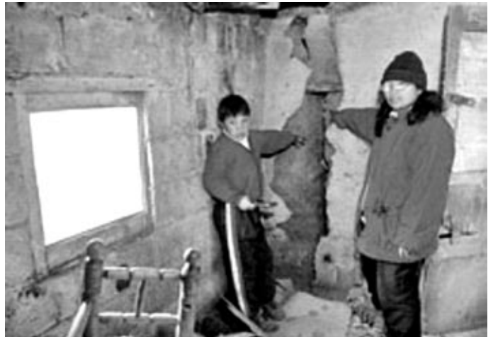
RIESGO. Viviendas cercanas a la mina tienen grandes grietas causadas por detonaciones.
